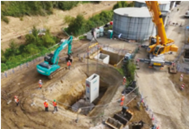
1,7M€ investis sur le site de Gondardennes pour récupérer les eaux de pluie sur 11 hectares.
