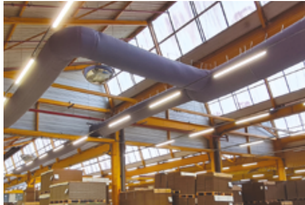
Nouveau système de chauffage des ateliers.
